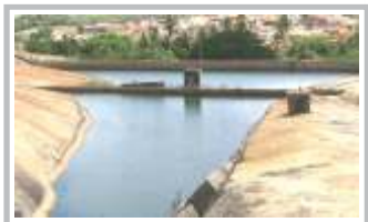
Vários reservatórios de água potável
